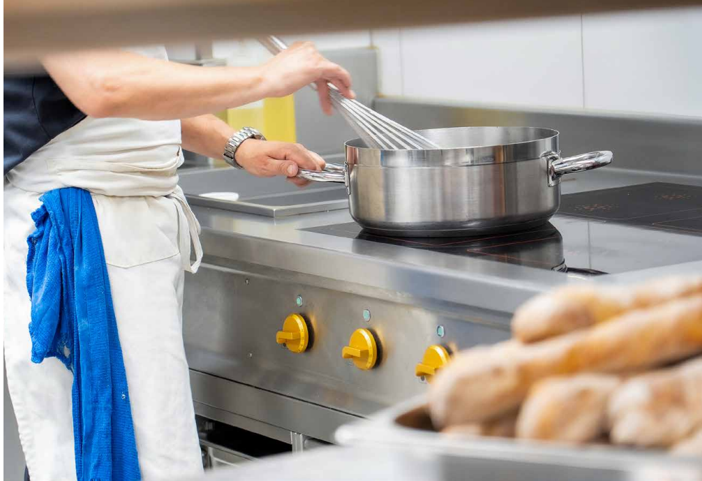
La pièce maîtresse de chaque cuisine Hugentobler – le fourneau suisse, dans la Brasserie Belleville avec grill à induction et fourneau, compacte et efficace en fonction de l'espace disponible.
