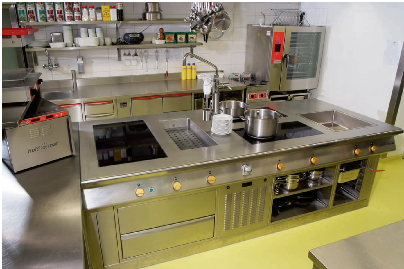
Blick in die helle und blitzsaubere Küche der «Company Lodge» mit dem Hugentobler «Schweizer Herd», dem Kombisteamer «Practico Vision», Hold-o-mat und CNS-Arbeitsflächen und -Korpuse — alles aus einer Hand unter dem Dach der Hugentobler AG.
